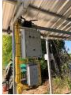
บอร์ดและวงจรไฟฟ้า
